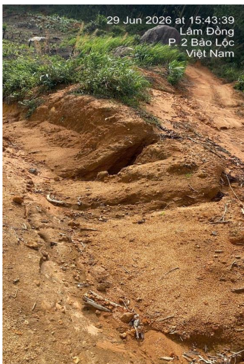
Hình 2. Xói lở đường vận xuất sau khai thác
